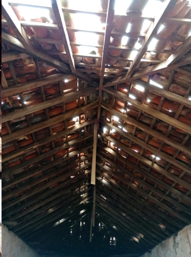
© Haciendas. Restos de la cubierta de las casas principales.
