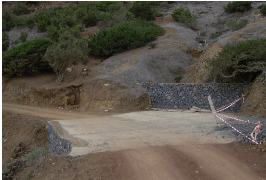
Figura 16.11 ; Obra de refuerzo de firme en camino forestal de La Gomera. (Santamarta JC,2009)
