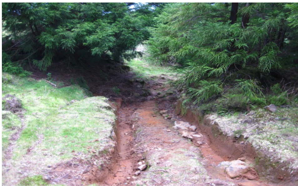
Figura 16.7 ; Erosión por poca capacidad portante del terreno, en camino forestal. (Santamarta JC, 2011)
