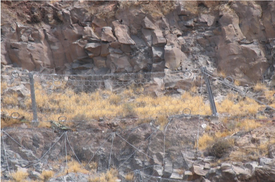
Figura 16.8; Barrera dinámica de protección de desprendimientos. (Santamarta JC,2009)
