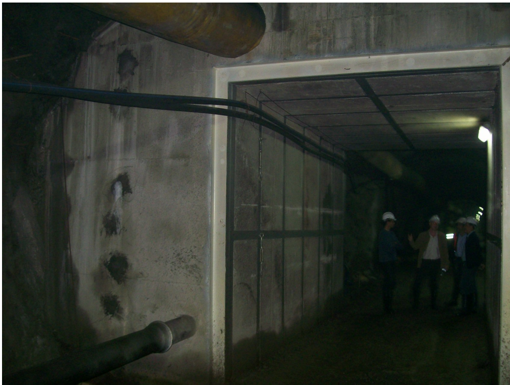
Figura 2. Vista de la estructura de hormigón armado y pase de conducciones y ventilación en la galería de Ipalám (Ing Soler Licerias) en La Gomera (SANTAMARTA J, 2009)
