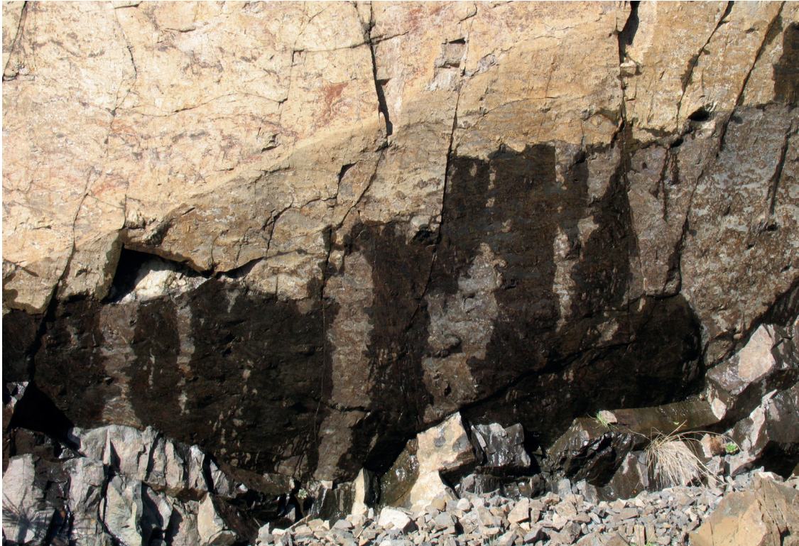
Figura 3.1.- Zona de contacto entre formaciones y presencia de agua en la fisura.
