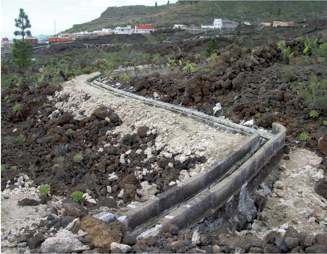
Figura 3.16.- Limpieza de canal debido a la precipitación de carbonatos.
