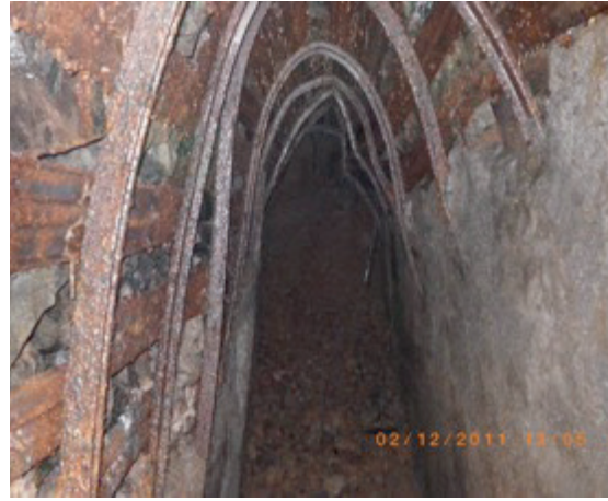
Figura 3.14.- Galería de agua que ha alcanzado el "mortalón" o depósitos de avalancha. (foto cortesía de Rafael Fenoll).
