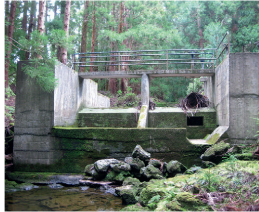
Figura 2.9.- Tomadero de aguas de escorrentía en la isla de Terceira, Azores.
