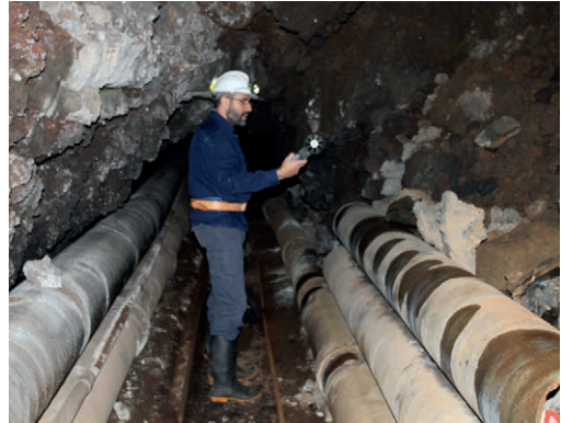
Figura 7.4.- Comprobación del funcionamiento de la ventilación.
