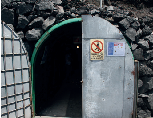
Figura 7.12.- Sistema de cierre de acceso a la galería con panel informativo.
