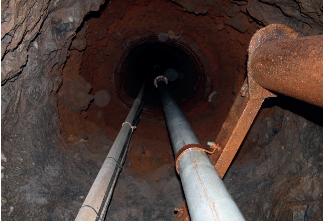
Figura 7.9.- Vista desde el fondo de un pozo canario y sus instalaciones de bombeo de aguas.
