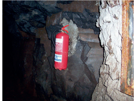
Figura 7.13.- Extintor en la sección de la mina de agua.
