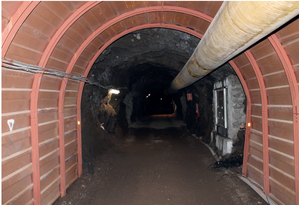
Figura 7.1.- Tubería flexible de ventilación.
