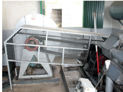
Figura 7.6.- Instalaciones de ventilación y de aire comprimido en una galería.
