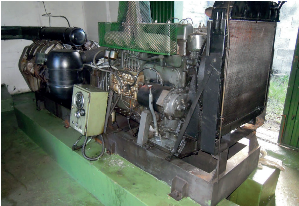
Figura 7.7.- Motor generador de energía para la instalación.
