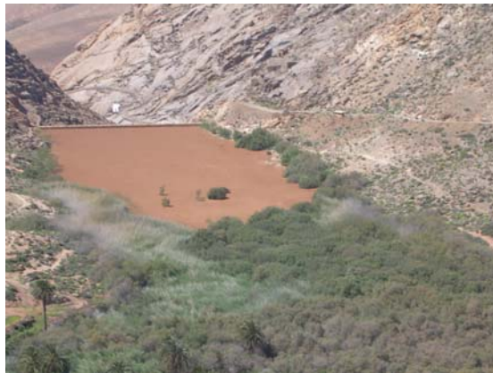
Figura 5 Presa de las Peñitas en la Isla de Fuerteventura , se observa que está totalmente aterrada por acarreo de materiales volcánicos en los barrancos. (Santamarta 2008).
