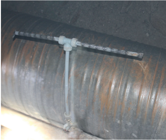
Figura A.16.- Grifo de aire comprimido a lo largo de la traza de la mina.
