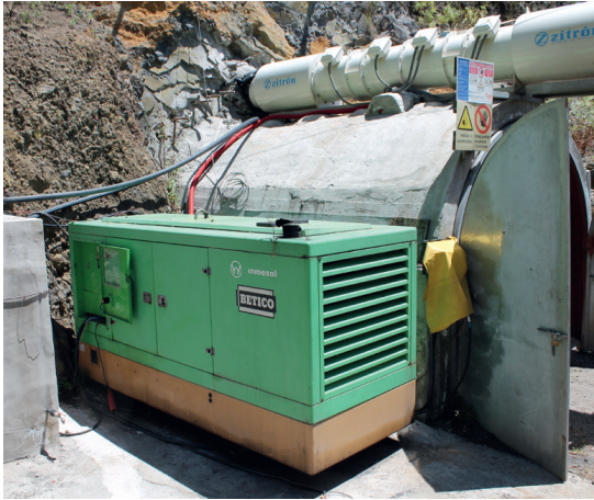
Figura A.6.- Equipo electrógeno para suministro energético de la obra.
