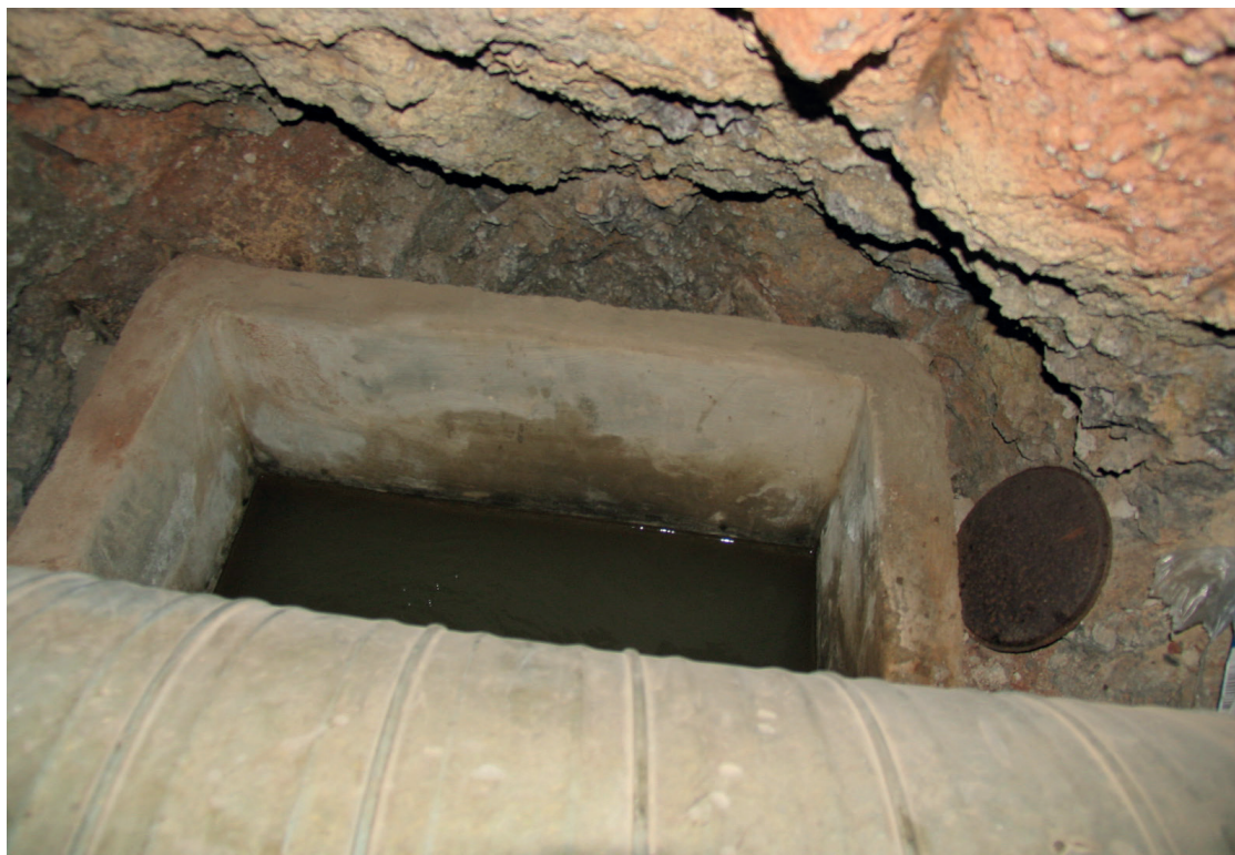
Figura A.2.- Tanquilla para aforo y control de caudales alumbrados.
