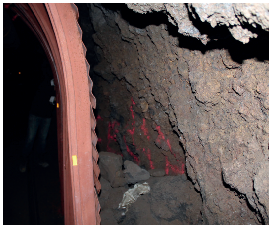
Figura A.4.- Zona escoriácea en la traza de la mina con problemas de sostenimiento.
